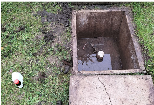
Branchement équipé d'un col de cygne par l'exploitant pour le suivi du contrôle sanitaire
