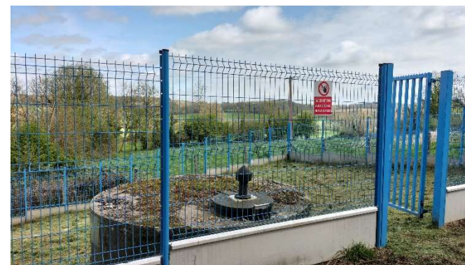
Captage d'eau et Périmètre de protection immédiate
