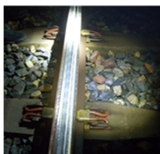
Figure 14: Rail après meulage
